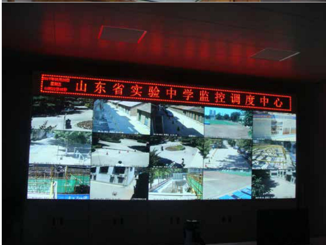
安全监控系统
